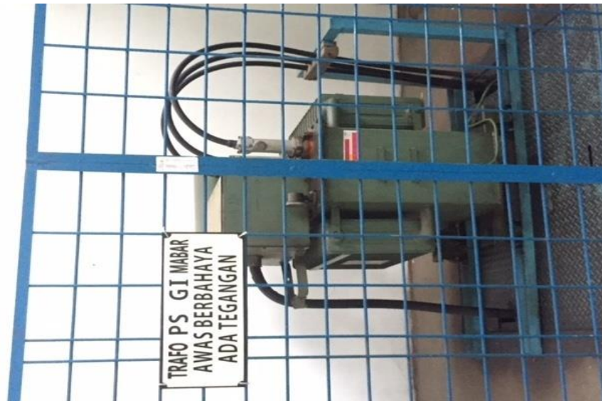
Gambar 2.13 Trafo PS GI Mabar (Sumber :Gardu induk mabar,2019)
