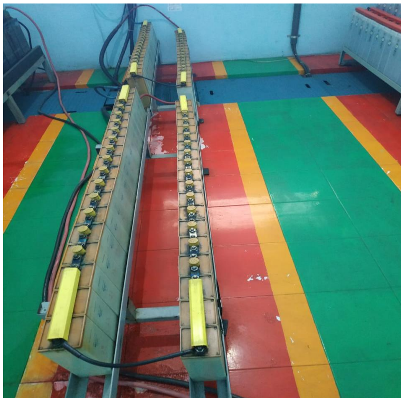
Gambar 2.10 Baterai 48 V GI Mabar Sumber : (Gardu induk mabar, 2019)
