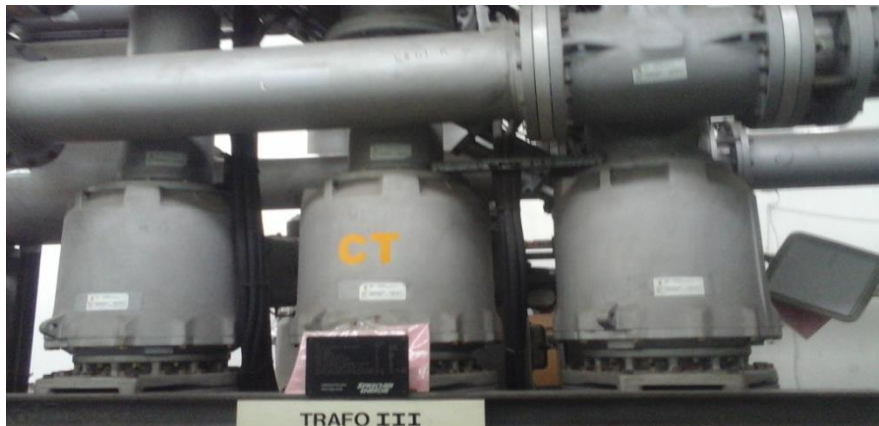
Gambar 2.2 Current Transformer pada GIS Mabar ( indoor ) ( Sumber: Gardu induk Mabar, 2019 )
