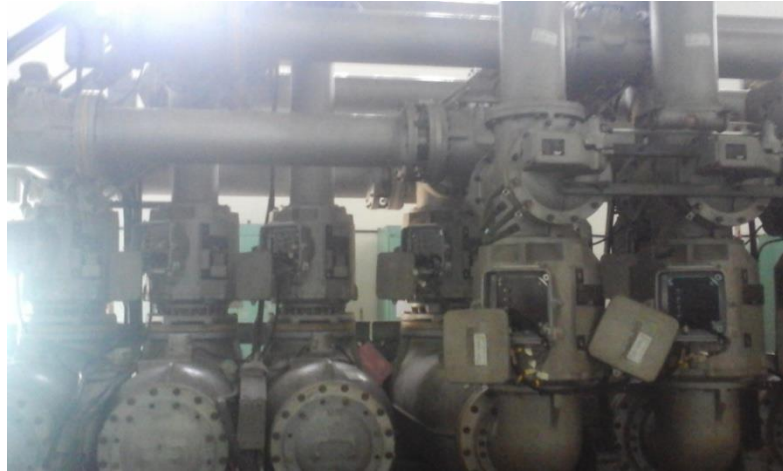
Gambar 2.4 Pemisah pada kompartemen GIS (Sumber :Gardu induk Mabar ,2019)
