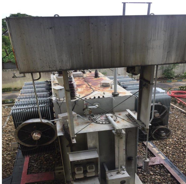
Gambar 2.6 Trafo Daya GI Mabar 150/20 kV (Sumber: Gardu induk mabar, 2019)
