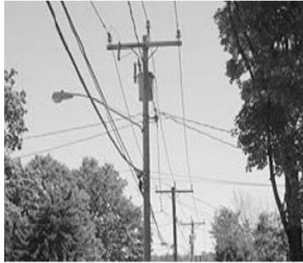
Gambar 2.1 Saluran Udara Tegangan Menengah (PLN Buku 5: Standar Konstruksi Jaringan Tegangan Menengah Tenaga Listrik, 2010)
