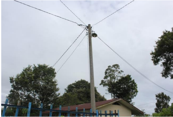
Gambar 2.4 Saluran Udara Tegangan Rendah (Dokumentasi Penulis, 2018)
