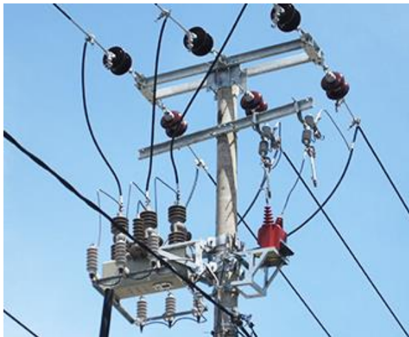
Gambar 2.12 Recloser (Dokumentasi Penulis, 2018)
