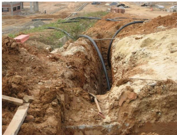
Gambar 2.5 Saluran Kabel Tegangan Rendah (Dokumentasi Penulis, 2018)
