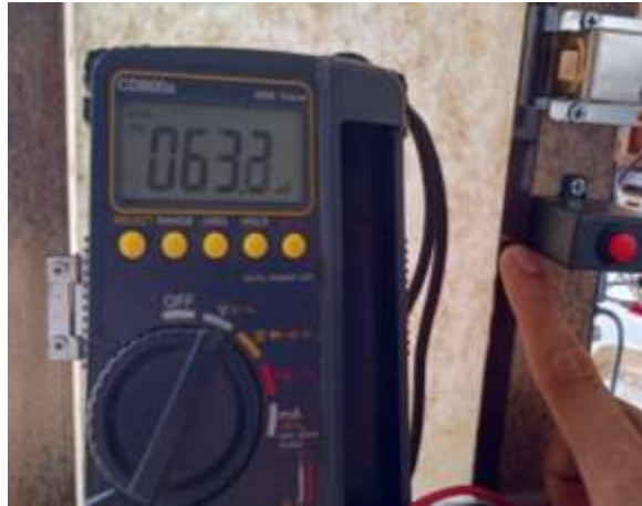
Gambar 4.8 Pengukuran Tegangan pada Relay ketika Push Button ditekan
