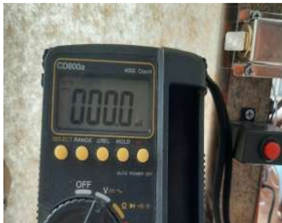
Gambar 4.5 Pengukuran Tegangan pada Magnetic Switch / Door Sensor ketika Magnet didekatkan
