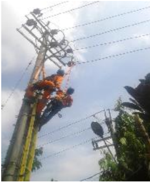
Gambar 4.3 Pemutusan Kabel Aresster
