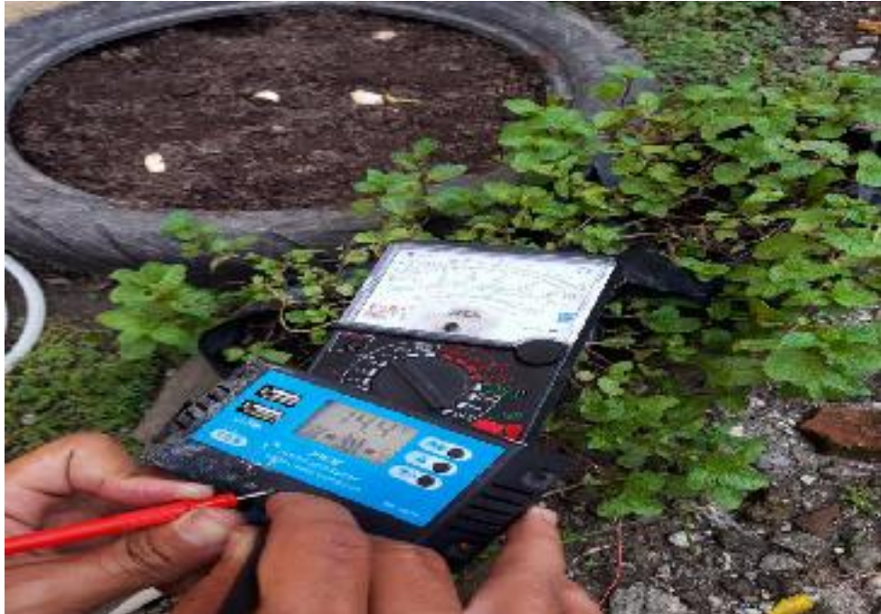
Gambar 4.4 pengukuran tegangan Output Scc Sumber: penulis 2020
