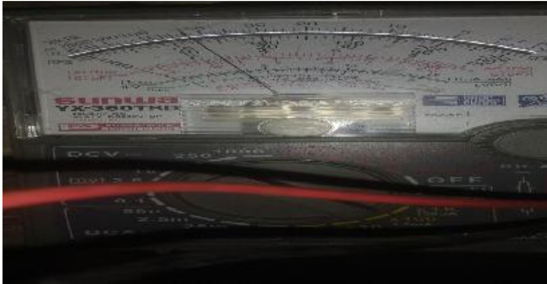
Gambar 4.2 pengukuran tegangan batrai
